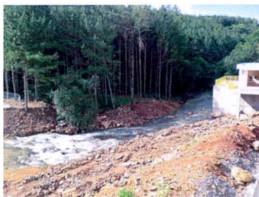
Figura 8 – Captação Rio do Cravo
