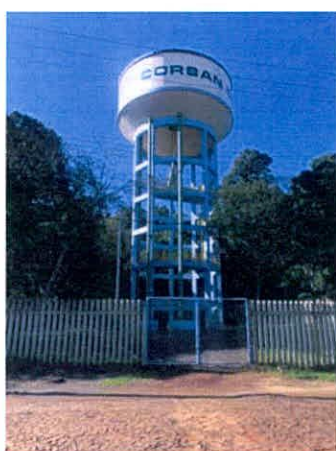
Figura 25 – Reservatório Elevado – Rua Alvar Izidro Coffy 2 (500 m 3 )
