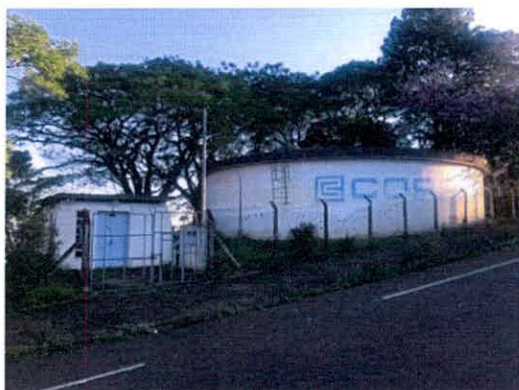
Figura 21 – Reservatório Apoiado – Rua Polônia (1.500 m 3 )
